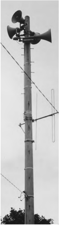
防災行政無線の鉄塔
